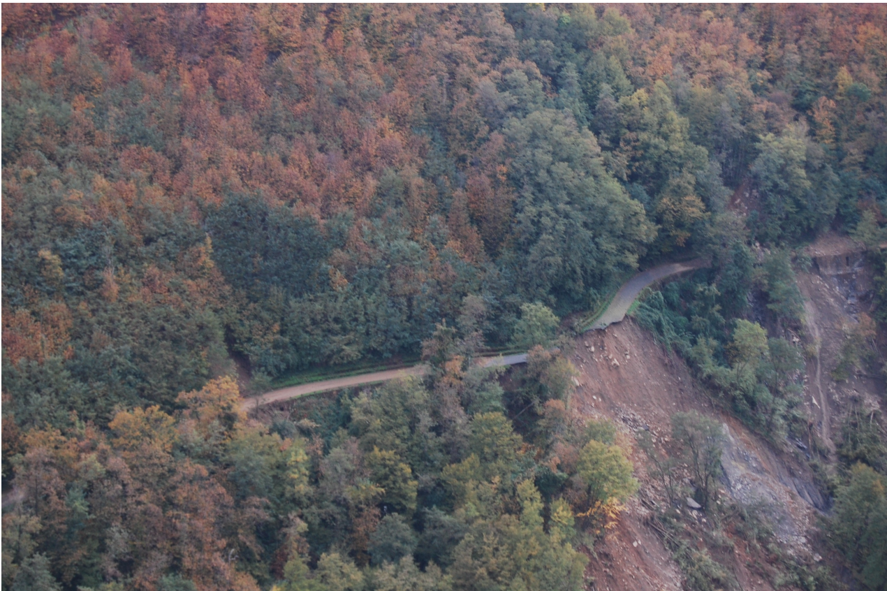
Smottamenti lungo la strada Provinciale (ore 16:15 del giorno 2 Novembre 2011).
